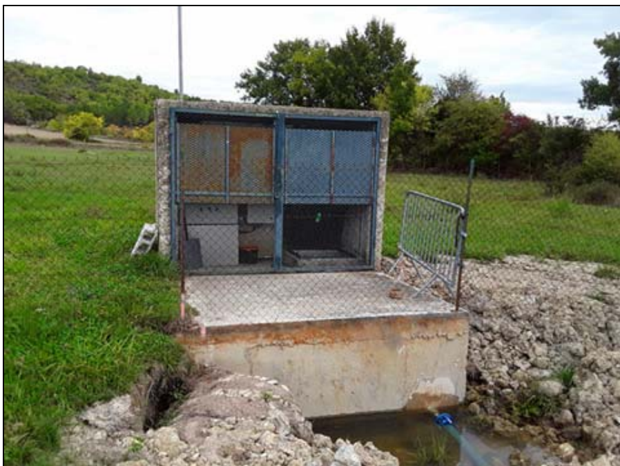
Station de pompage - local à pompes.
