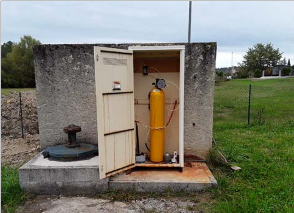
Local où est placée la bouteille de chlore tout contre la station.
