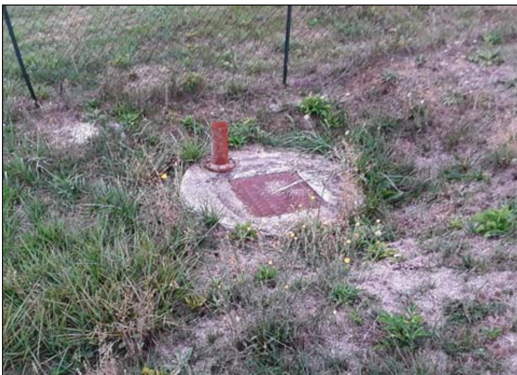
Regard qui permet le réglage du débit de l'eau qui va vers les 3 fontaines du village.
