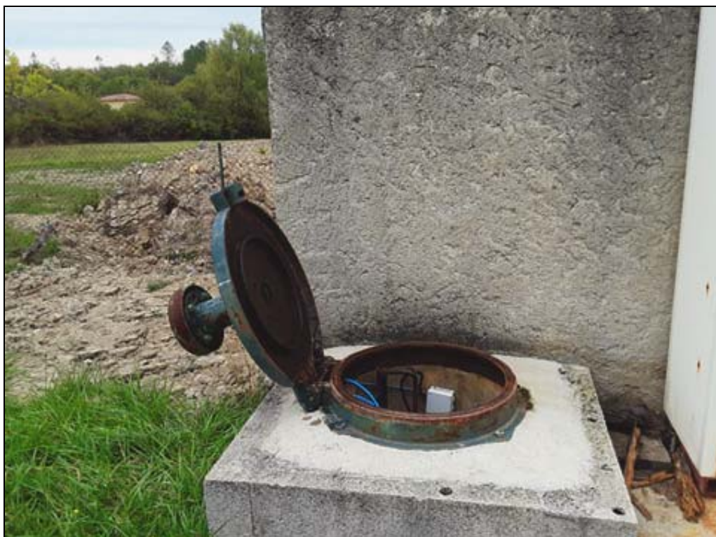
Passage obligé de l'eau avant la station.
